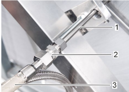
Abbildung 57: Anschluß der Wasserversorgung
